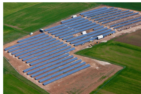
Νέο έργο της ADVARTIA ισχύος 1 MWp στην περιοχή του Κιλκίς
