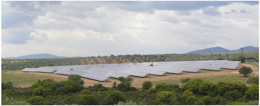
Νέο έργο της ADVARTIA ισχύος 500kWp στην περιοχή της Χαλκιδικής
